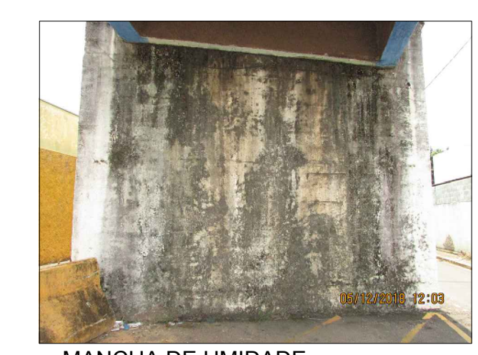
MANCHA DE UMIDADE NO ENCONTRO
